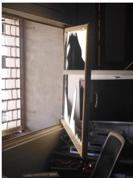
Glasschade aan de Dekwene Church
